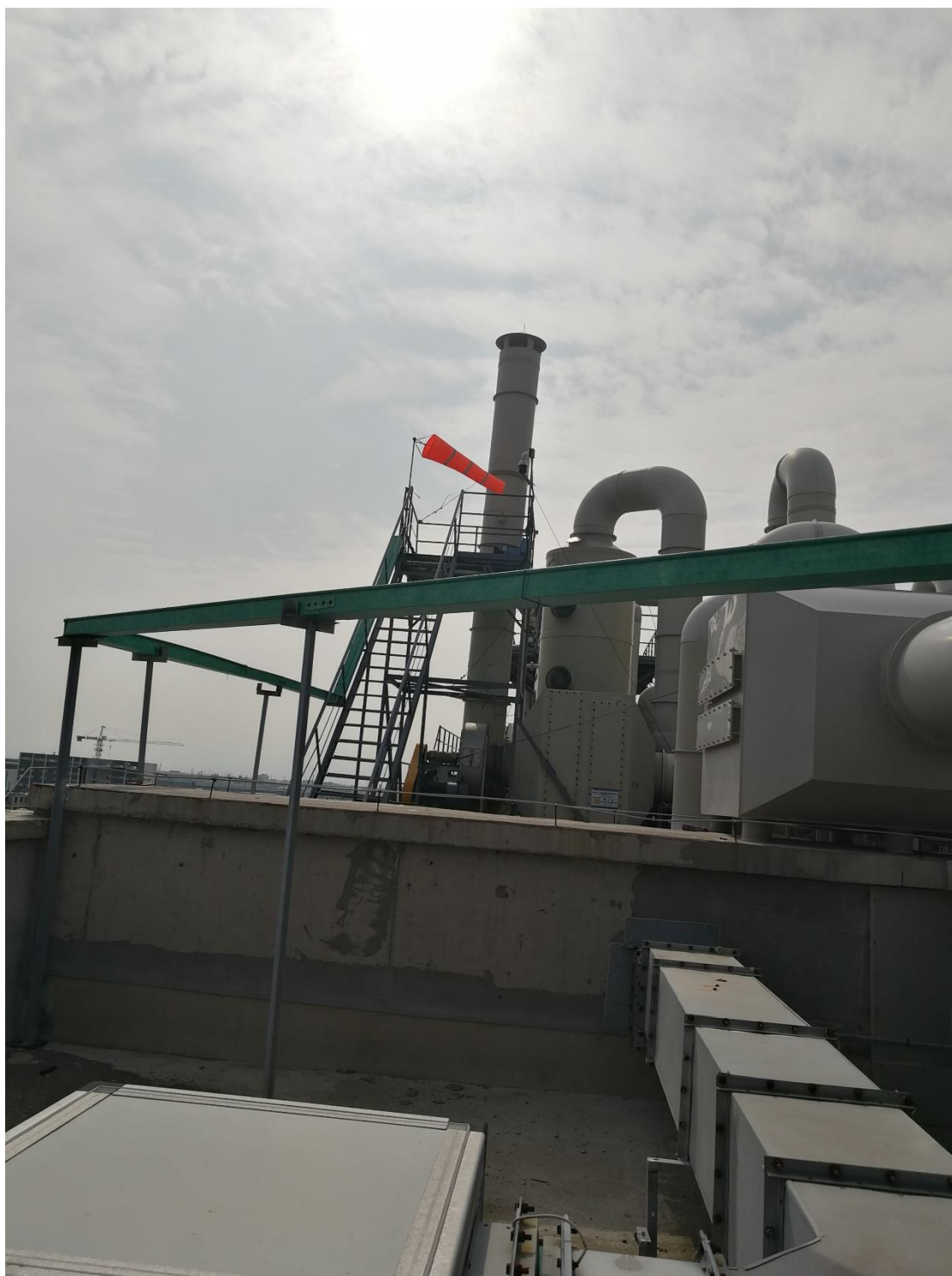
图 4.2-16 废气排放口标志牌、取样平台
