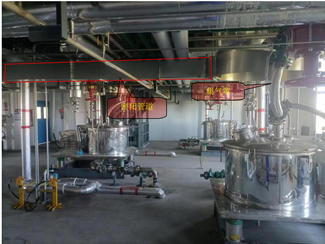
图 4.2-2 车间一废气收集装置——集气罩及密闭管道
