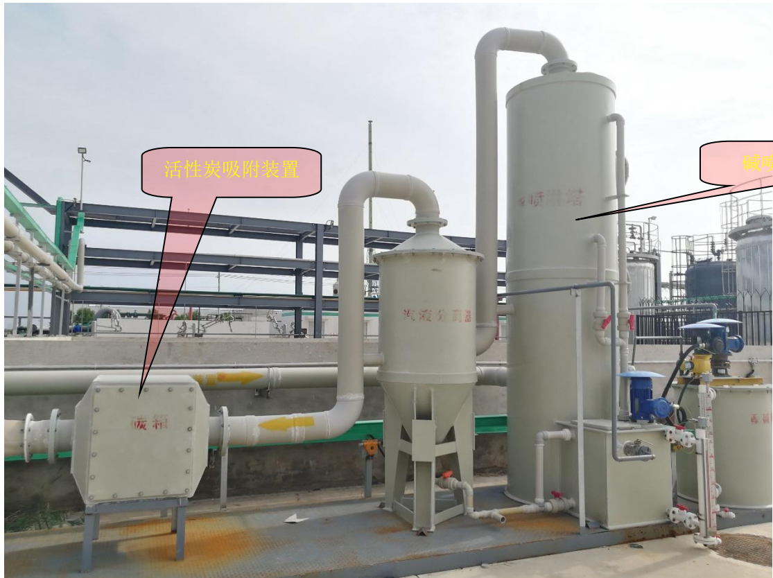
图 4.2-7 罐区废气处理装置
