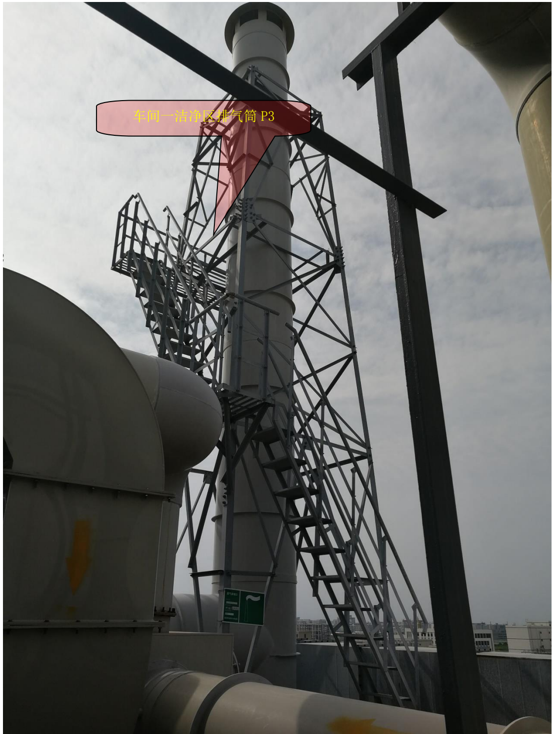
图 4.2-5 车间一洁净区废气处理装置
