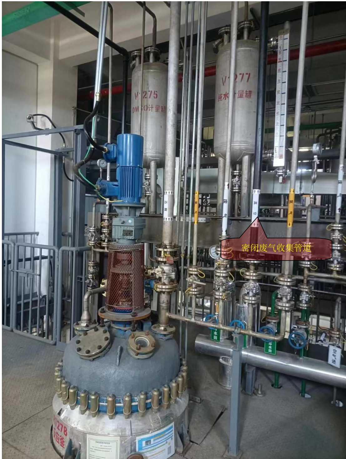
图 4.2-3 车间一有机废气密闭管道
