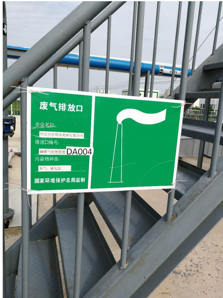
图 4.2-17 废气排放口标志牌、取样平台
