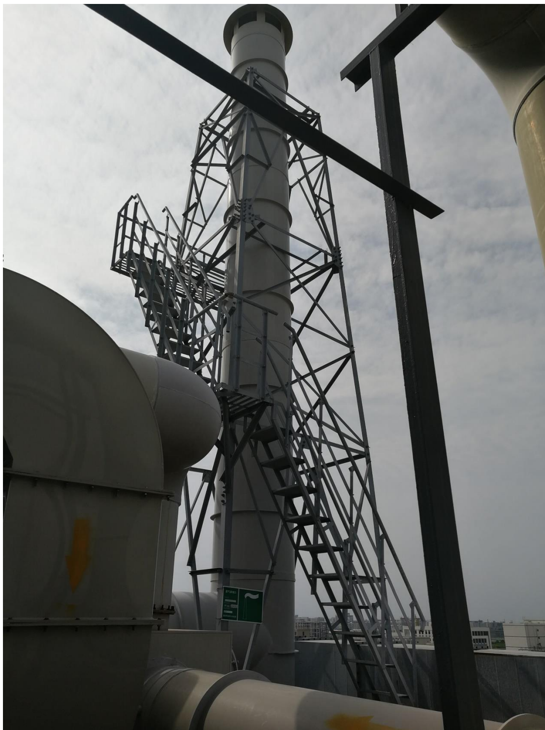
图 4.2.-15 废气排放口标志牌、取样平台图
